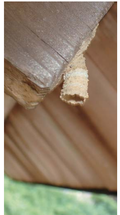
図4. 屋根裏に作られたエントツドロバチの巣。
