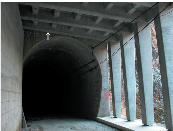
図 4. 隧道と洞門の隙間のある位置。
