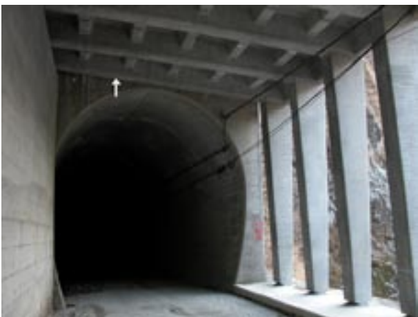
図 4. 隧道と洞門の隙間のある位置。
