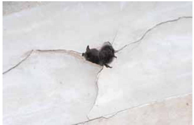
図 3. ひび割れた部分に入り込むモモジロコウモリ（清川トンネル）。
