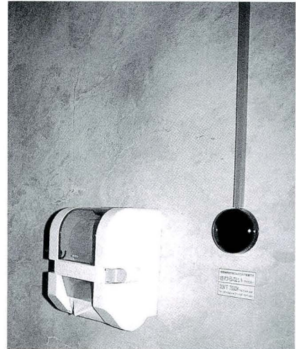
図3. トイレ内のペーパーの傍に取り付けられた「発光部」.
