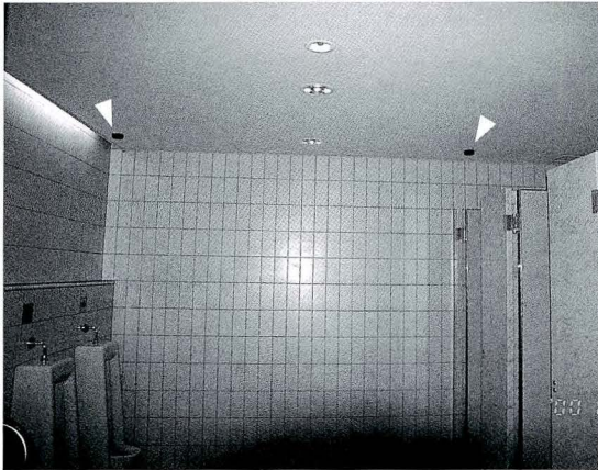
図2. 男子トイレ内の天井に設置された「発光部」.
